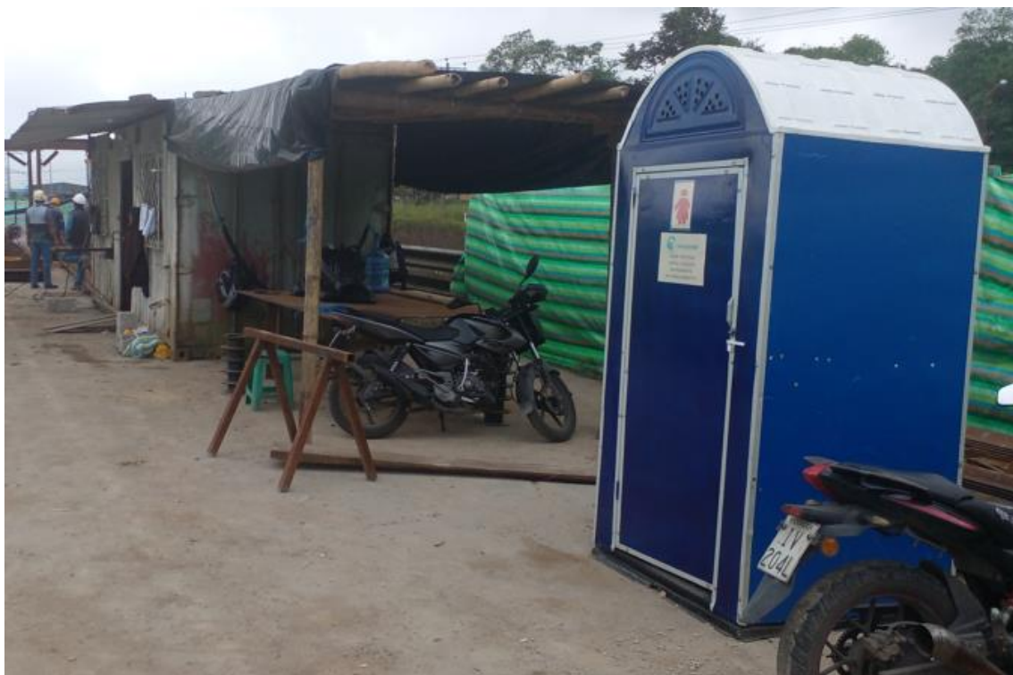
Batería sanitaria empleada en obra
