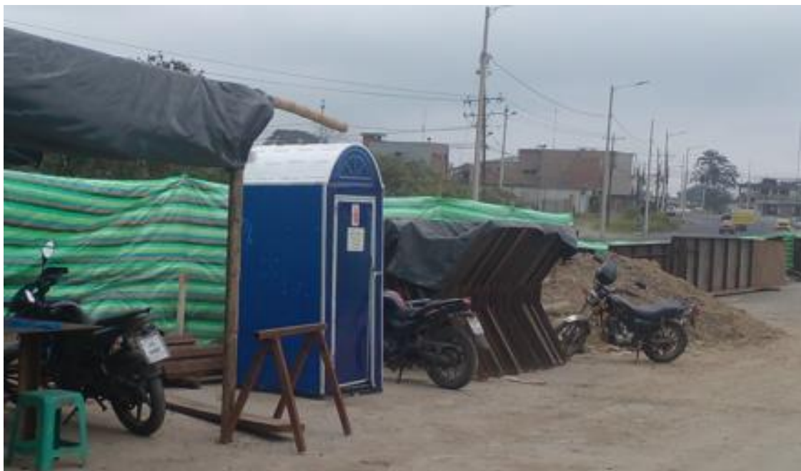
Batería sanitaria empleada en obra
