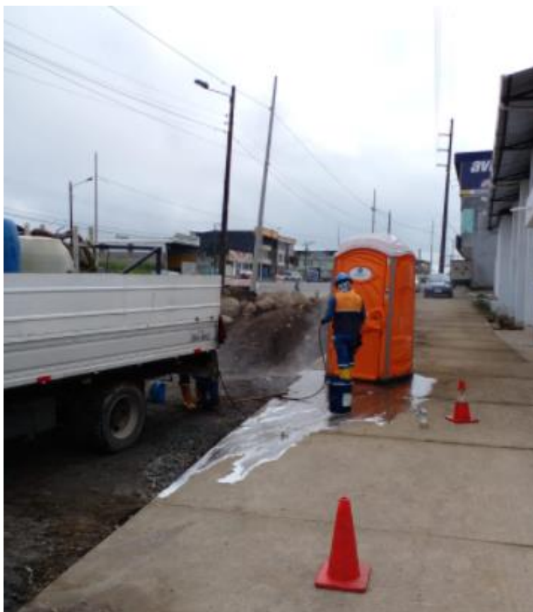
Batería sanitaria empleada en obra
