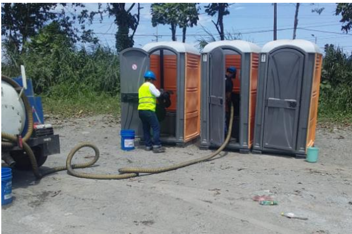
Batería sanitaria empleada en obra
