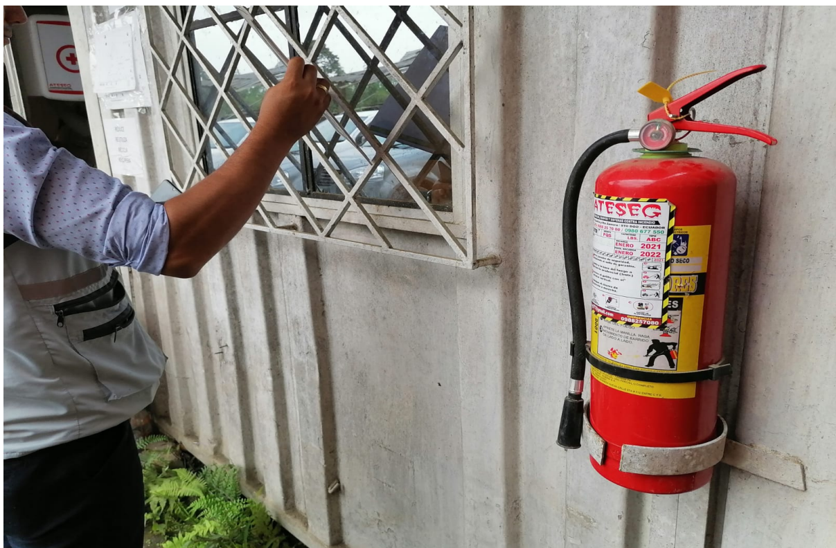
Extintor de 10 lbs clase ABC señalizado y vigente
