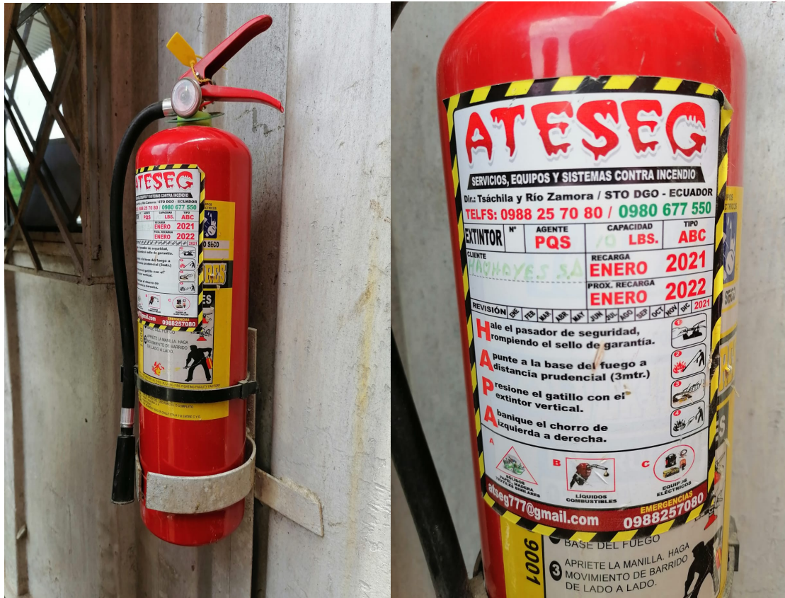
Extintor de 10 lbs clase ABC – Ubicado afuera de las oficinas del campamento
