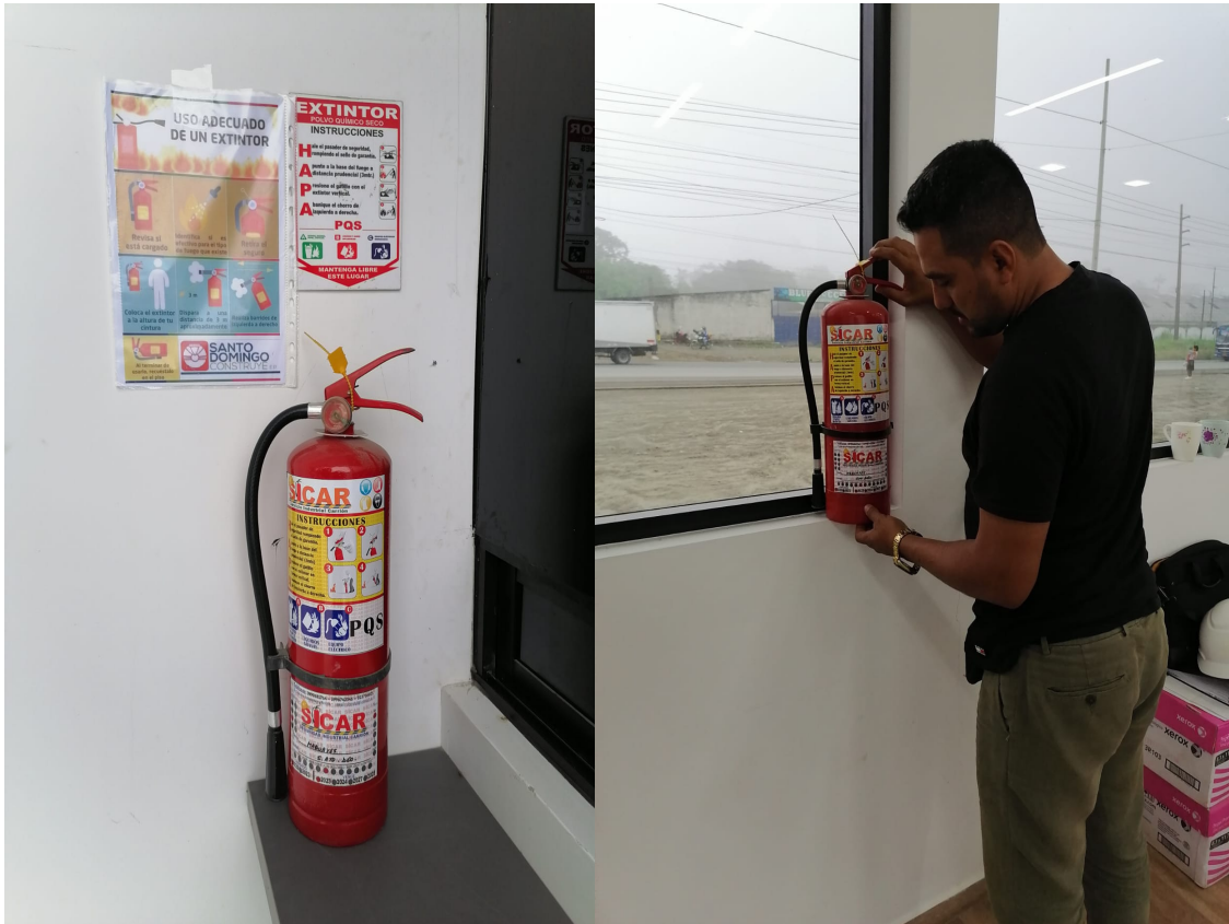
Extintor de 10 lbs clase ABC señalizado y vigente
