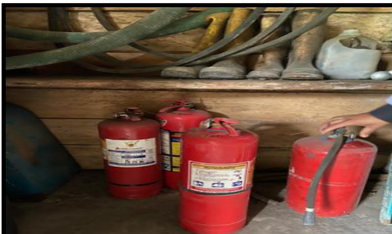
Ilustración 6. Extintores de la Mina La Fortaleza X=698582 Y=9984918
